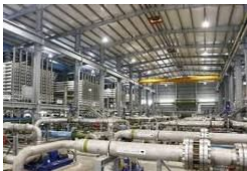
Ras Abu Fontas impianto desalinizzazione/desalination plant
